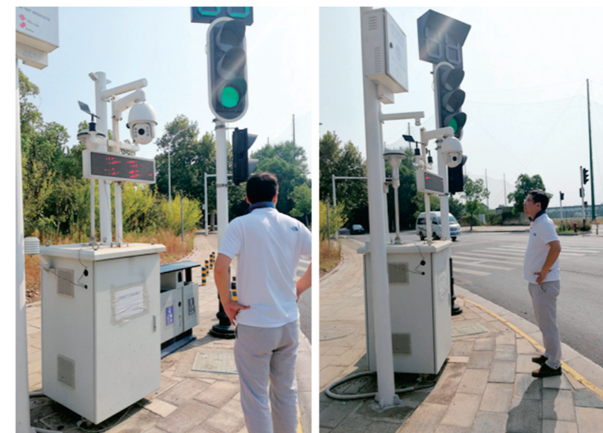
图2 鲁磨路道路扬尘监测站
